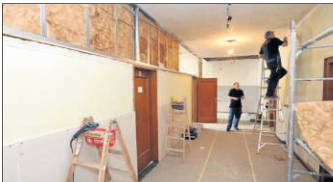
In diesem Jahr steht eine größere Investition an: Büroetage, Foyer und Toilettenanlagen werden derzeit saniert. ■ Foto: Wiemer
